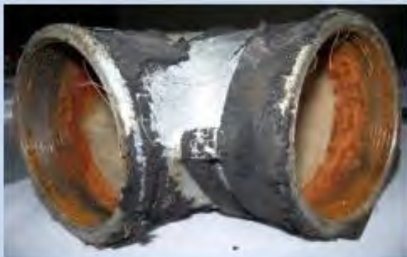
Presenza di ruggine
